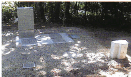
Le poste de relevage
