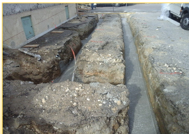
LOT n° 1 : MACONNERIE et DEMOLITION : Entreprise LAPEYRE Vincent (Augignac) Montant du marché : 40 450,16 € HT
